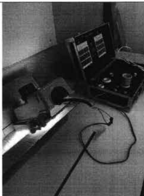
Foto 15 – Amostra do item 1.1.1 – medições de parâmetros elétricos
