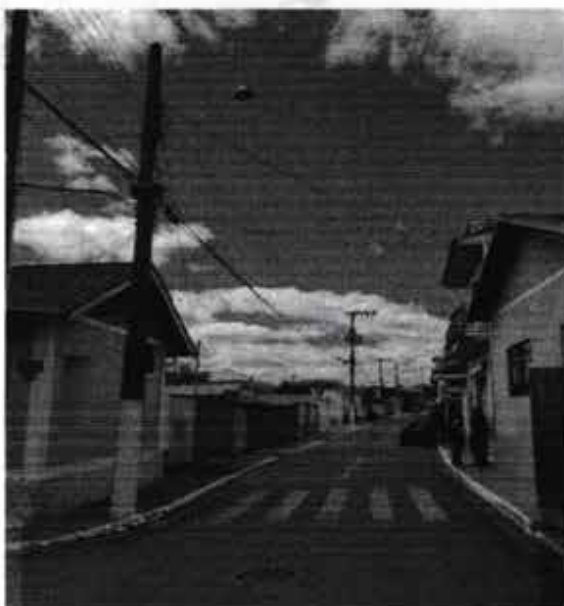
Figura 1 - Poste de concreto circular com luminária LED 90 W, localizado na Rua Camilo C. de Melo.
