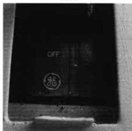
Figura 13 – Disjuntor do prédio da CEMEI Dona Benta
