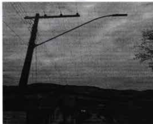
Figura 2 – Poste de concreto DT com luminária LED, localizado na Rua Adélio Madson esquina com Rua Nossa Senhora das Graças
