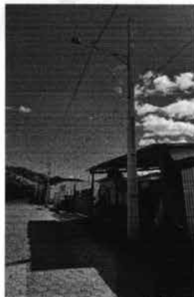
Figura 2 – Poste de concreto DT com luminária LED, localizado na Rua José Patrício Paiva
