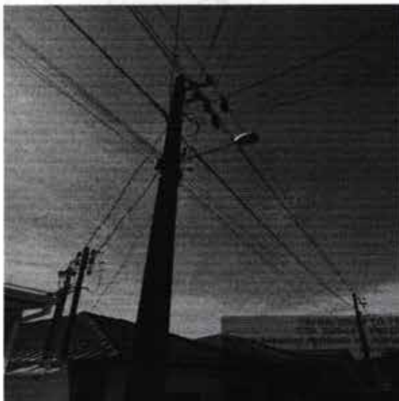
Figura 1 - Poste de concreto tipo duplo T com luminárias abertas com lâmpada vapor de mercúrio de 125 W, localizado na via Manoel Antônio de Almeida.
