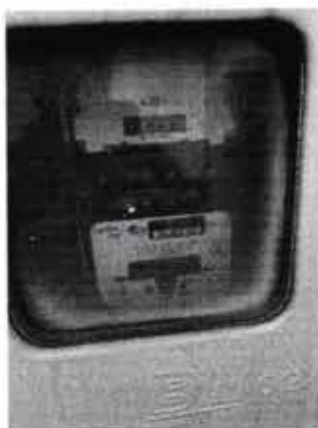
Figura 12 – Medidor da Ubs Ponte Segura
