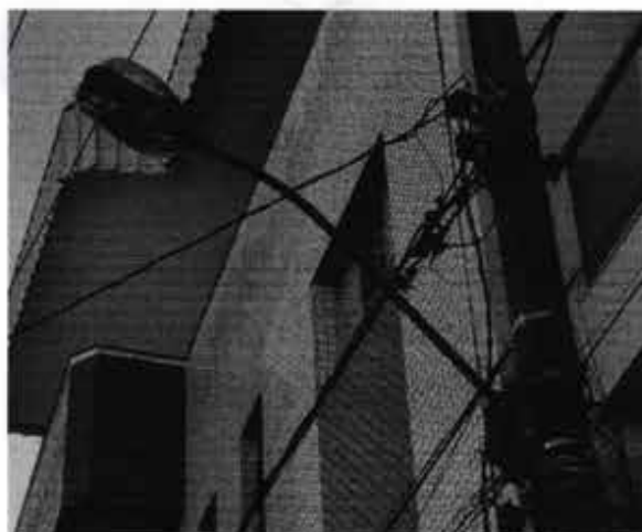
Figura 2 – Poste de concreto circular com luminária aberta com lâmpada de vapor de sódio, localizado na Rua João Silvério.
