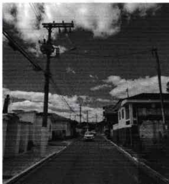
Figura 2 – Poste de concreto circular com luminária LED (potência desconhecida), localizado na Rua Camilo C. de Melo.
