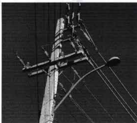
Figura 1 - Poste de concreto DT com luminária aberta e lâmpada Vapor de Sódio, localizado na Av. José Augusto de Rezende.
