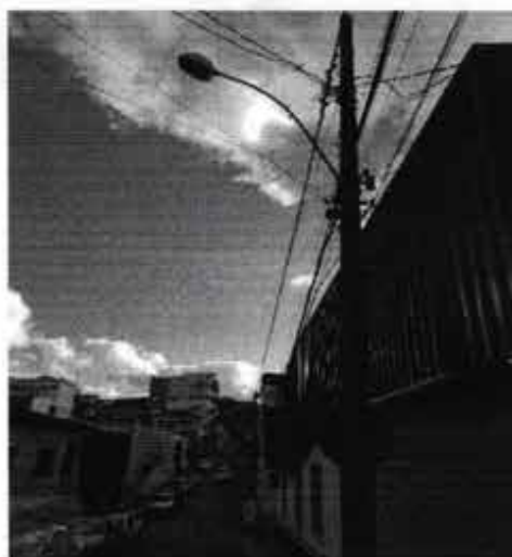
Figura 2 – Postes de concreto circular com lâmpada vapor de mercúrio 125 W, localizado na Rua Professor Ramos
