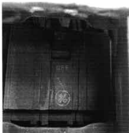
Figura 11 – Disjuntor da Escola Municipal Elvira De Castro Bernardes
