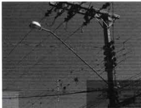
Figura 2 - Poste de concreto DT com luminária aberta e lâmpada Vapor de Sódio, localizado na Rua Prefeito Pedro Moreira Borges.
