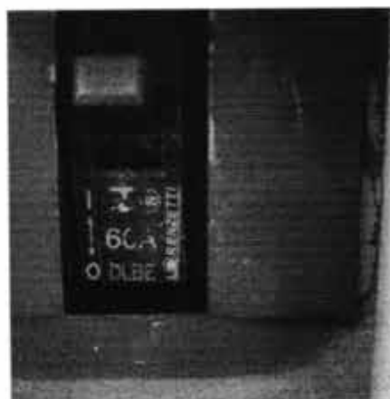
Figura 15 – Disjuntor da Escola Municipal Alfeu Duarte
