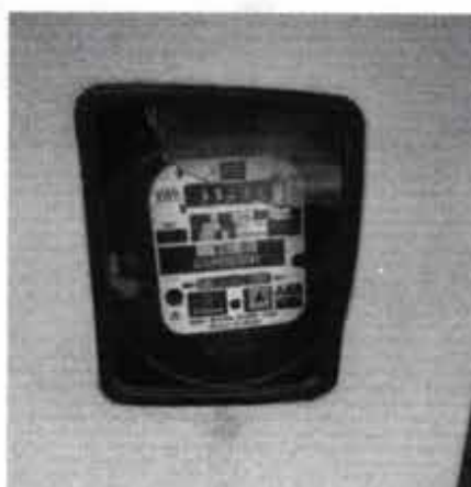
Figura 10 – Medidor eletrônico da Creche Municipal Tereza Rodrigues de Souza
