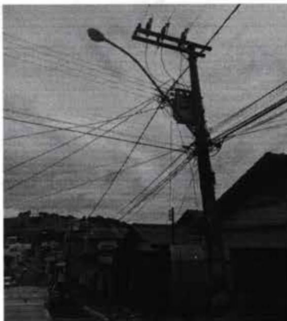
Figura 1 - Poste de concreto circular com luminárias fechadas com lâmpada vapor de sódio de 250 W, localizado na via Rua Prefeito João Batista Filho.
