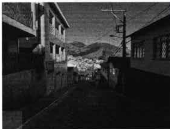
Figura 1 - Poste de concreto circular com luminárias abertas com lâmpada vapor de sódio de 125 W, localizado na via Rua Doutor Joubert Guimarães.
