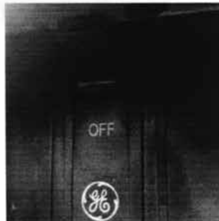
Figura 13 – Disjuntor da Escola Municipal Prof. Wilma Peroni
