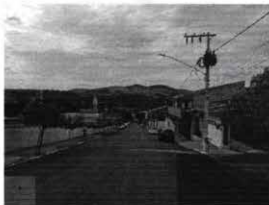
Figura 2 – Poste de concreto DT com luminárias LED, localizado na Rua Tomás Antônio Gonzaga
