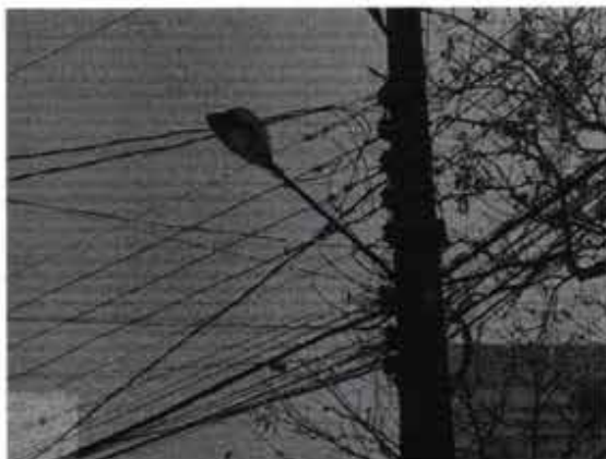
Figura 1 - Poste de concreto DT com luminária aberta e lâmpada Vapor de Mercúrio, localizado na Rua Amadeu Tavares da Silva.
