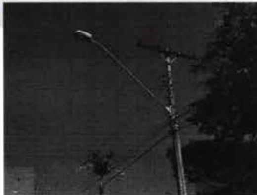
Figura 2 – Poste de concreto DT com lâmpada vapor de sódio localizado na Rua José Clícério Chagas
