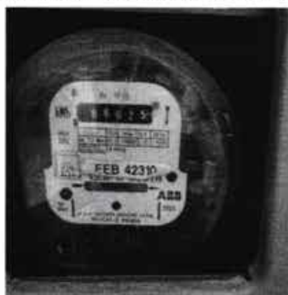
Figura 13 – Medidor eletrônico da Escola Municipal Dr. Moreira Brandão
