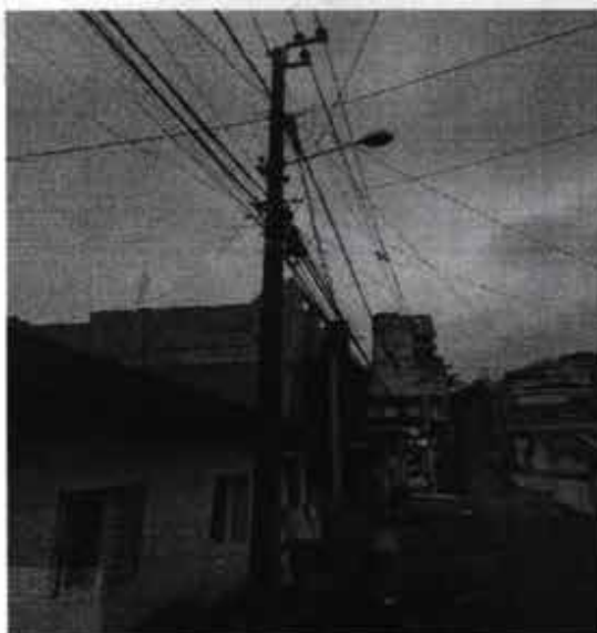
Figura 1 - Poste de concreto duplo T com luminária aberta com lâmpada vapor de mercúrio de 125 W, localizado na via Travessa Paiva nº 130
