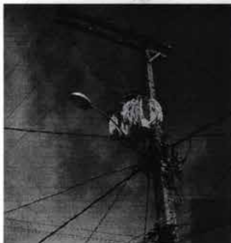
Figura 1 – Foto de poste de concreto DT com luminária aberta e lâmpada vapor de sódio 70W, localizado na Rua João Machado Homem.
