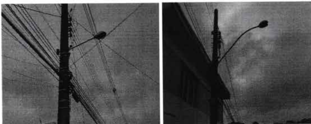
Figura 4 - Braços de iluminação pública fora de padrão da concessionária, respectivamente Tipos PA4 e Leve I.
