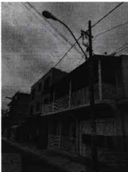
Figura 1 - Poste de concreto circular com luminária LED, localizado na via Rua Afonso Pena.
