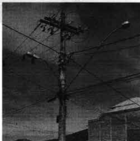
Figura 2 – Foto de poste de concreto circular com duas luminárias e lâmpadas a vapor de sódio 70W e 150W, localizado na Rua Antônio Pires do Prado esquina com Rua Vereador Antônio Francisco.
