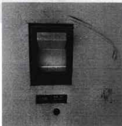
Figura 10 – Disjuntor do prédio da Cemei Prof. Maria Jose
